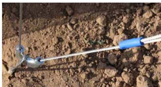
Верхнее фото. Проволочный трос, установленный в верхней части деревянного столба Нижнее фото. Муфта и твистор
